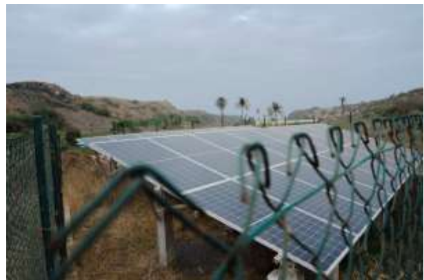
Mit Solarpaneelen wird eine Brunnenpumpe betrieben, doch das Wasser reicht nicht aus Foto: Carmen Abd Ali / DER SPIEGEL
