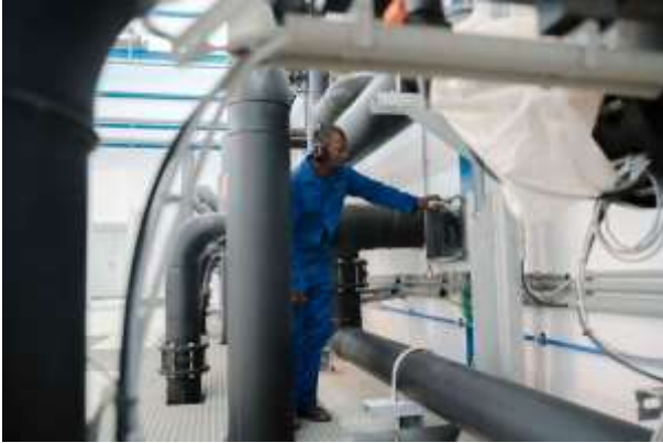
Hier wird 90 Prozent des Leitungswassers von Santiago Island bereitgestellt Foto: Carmen Abd Ali / DER SPIEGEL
